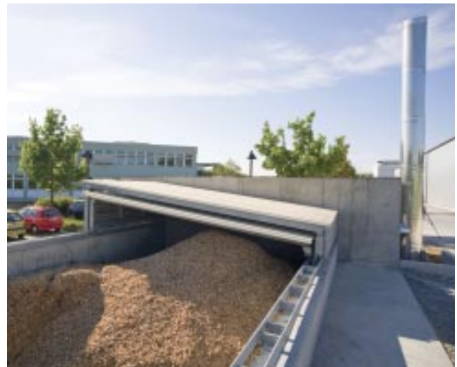
Je nach Wärmebedarf wird die erforderliche Menge Holzhackschnittzel aus dem Vorratsbunker automatisch der Heizanlage zugeführt.
