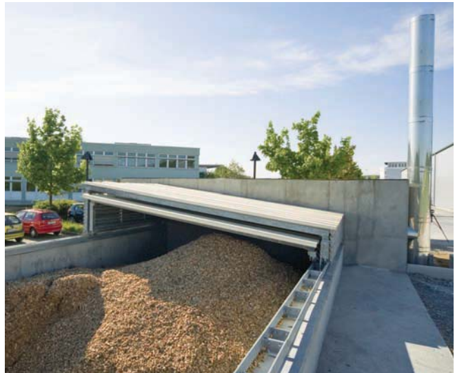
Je nach Wärmebedarf wird die erforderliche Menge Holz-Hackschnitzel aus dem Vorratsbunker automatisch der Heizanlage zugeführt.
